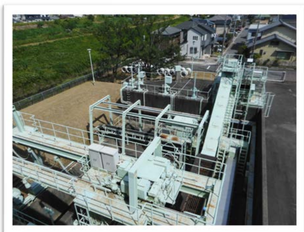
写真 2-7.落合ポンプ場（沈砂池）
