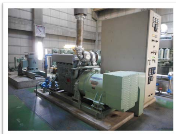
写真 2-8.落合ポンプ場（自家発電機）
