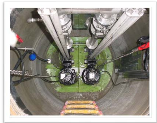
写真 2-4.マンホールポンプの内部
