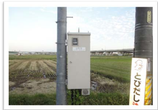
写真 2-5.マンホールポンプ制御盤
