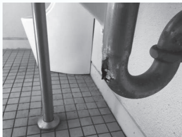
▲壊された洗面台排水管
