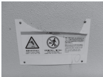
▲割られた注意プレート
