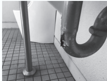
▲壊された洗面台排水管
