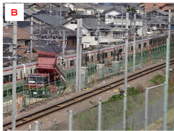
B 福祉体育館より一ツ木方面を望む(本体工事施工中)
