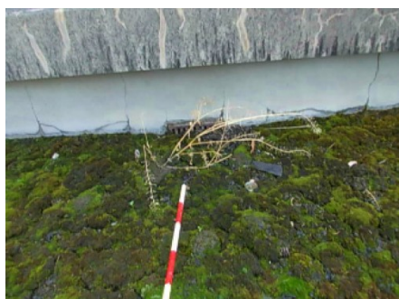
図表 6-2 ドレン目詰まりの例
