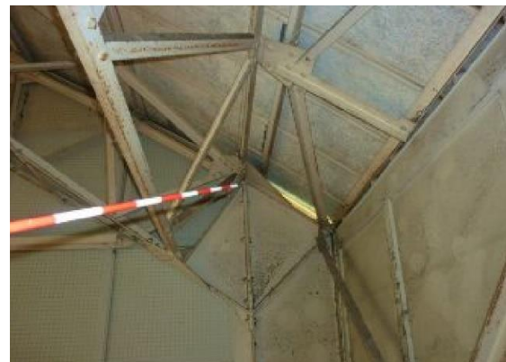
写真 屋根の腐食状況（端部）
