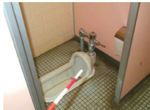
写真 水洗の異常
