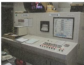
自動制御設備
