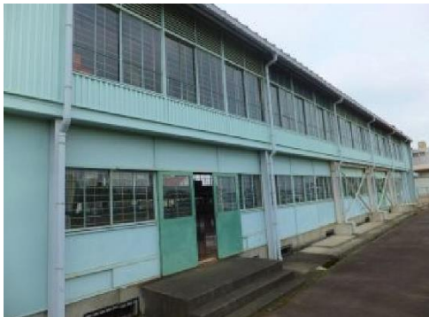
写真 外壁塗装の全体的な劣化
