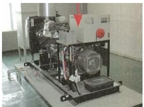
電気設備（自家発電等）
