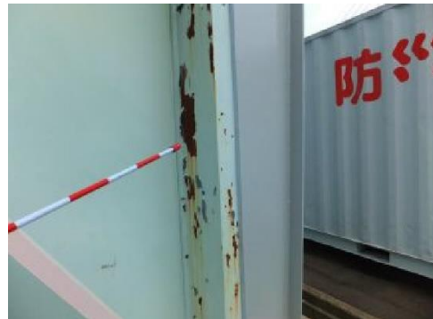
写真 鉄骨の錆
