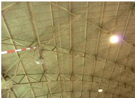
写真 室内屋根材の腐食（遠望）
