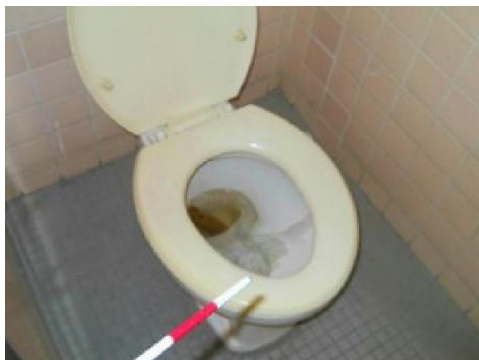
写真 洋便器の排水不良
