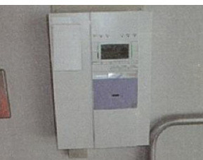
機械警備設備
