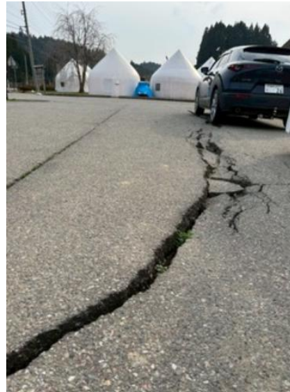
のと復耕ラボ駐車場のひび割れ 幅 8cm ほど
