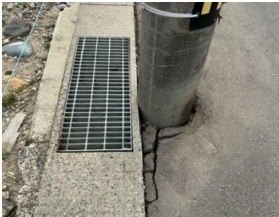
電柱の根元が液状化で沈んでいる
