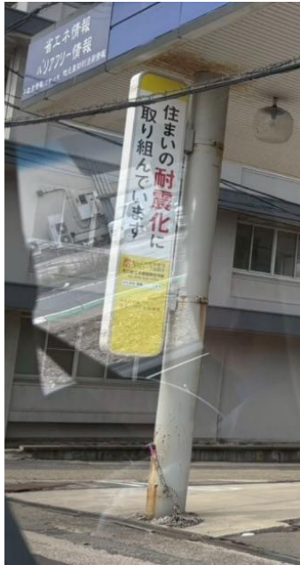
「耐震化に取り組んでいる」とあるが看板から傾いている店舗
