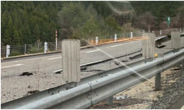
のと里山海道 隆起陥没のためアップダウン激しい 谷側の道が数か所崩落している
