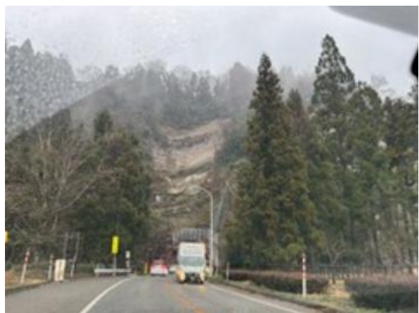
トンネルの上の土砂が崩れている。 地震が起こったらトンネル内で閉じ込めになりそう
