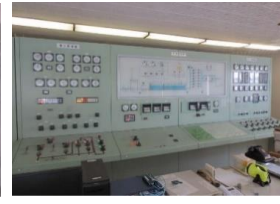
監視制御設備
