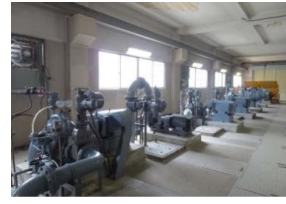
配水ポンプ設備
