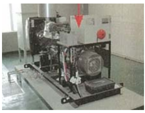
電気設備 (自家発電等)
