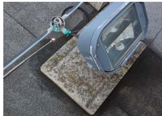
文化会館 (電管ジョイントボックスカバーなし
