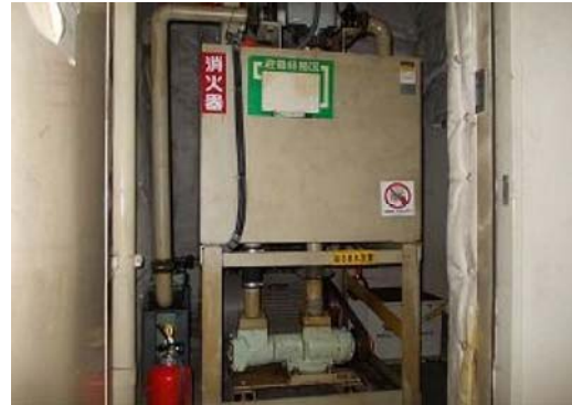
市民体育館 (油圧エレベーター作動不良※ヒアリング →2018年度更新済)
