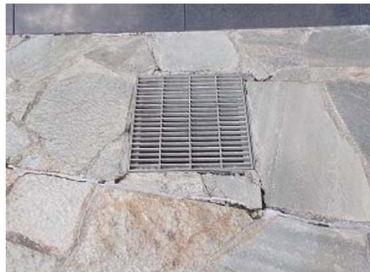
文化会館 (床石の浮き)
