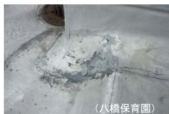
(八橋保育園) 防水シートの部分的な劣化
