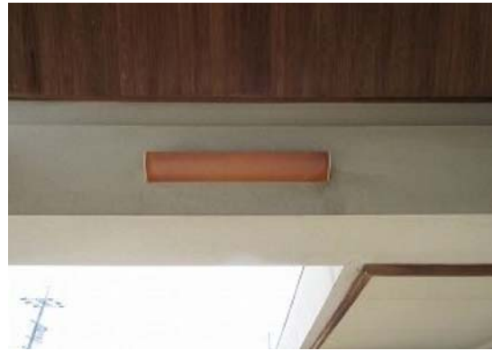
南児童センター (照明カバー錆)
