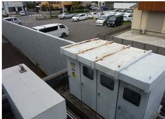
保健センター・かとれあワークス (発電機屋根の赤錆 外灯ボックスの錆複数 等)
