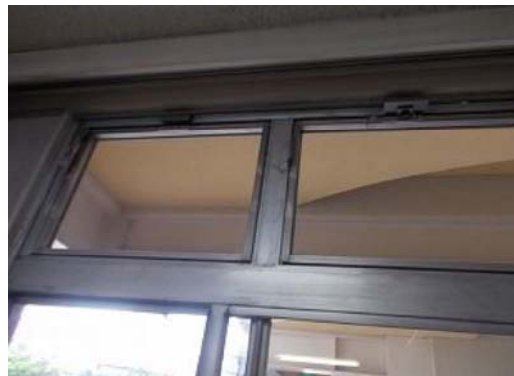
宝保育園-園舎 (排煙窓ワイヤー切れ)
