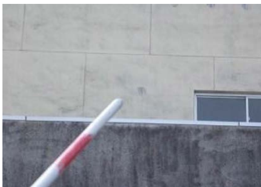
知立東小学校-校舎 (外壁の剥落、鉄筋露出)
