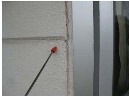
写真 地域福祉センター（作業棟） 目地割れ（全体的にあるが漏水なし）
