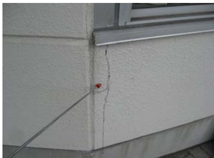
写真 地域福祉センター（作業棟） 外壁のひび割れ
