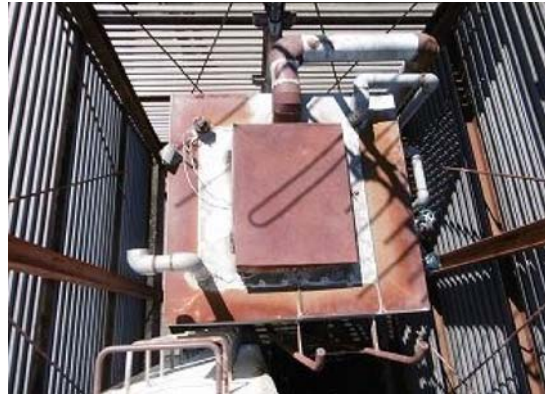
知立文化広場-ソーラー棟 (膨張タンク 上部錆)
