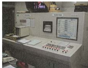
自動制御設備
