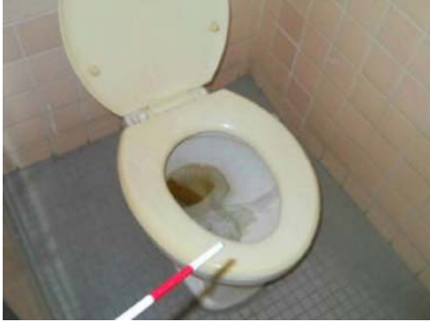
写真 洋便器の排水不良
