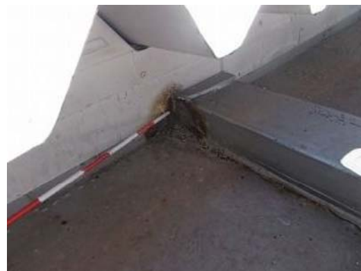
逢妻浄苑-火葬場 (屋根鉄部の孔食-天井漏水あり)
