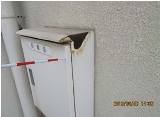
花山児童センター (配電ボックスの錆)
