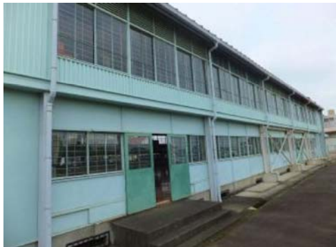
写真 外壁塗装の全体的な劣化
