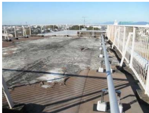
事例 防水シートの全体的な破損
