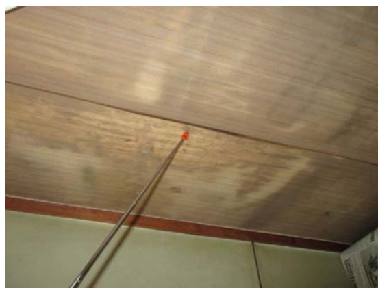
写真 天井の漏水痕（腐朽症状がみられるとのこと）
