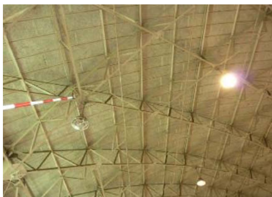
写真 室内屋根材の腐食（遠望）
