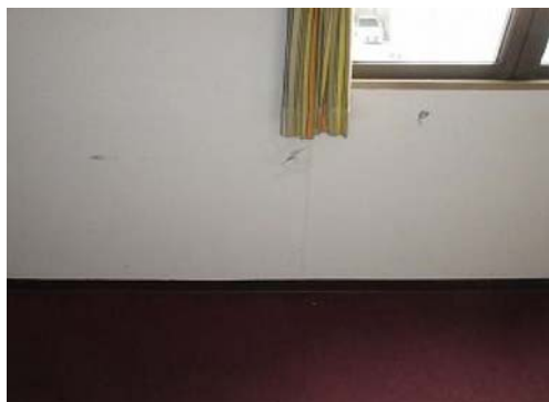
中央公民館-公民館 (サッシ廻りの漏水痕)
