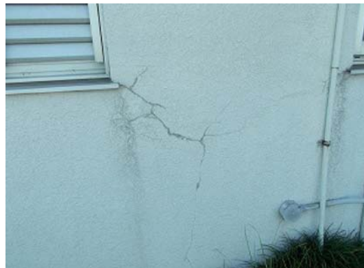
昭和グランド-管理事務所 (外壁ひび割れ)
