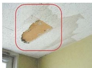
内装天井等 欠損箇所や汚損箇所の 部分取替等
