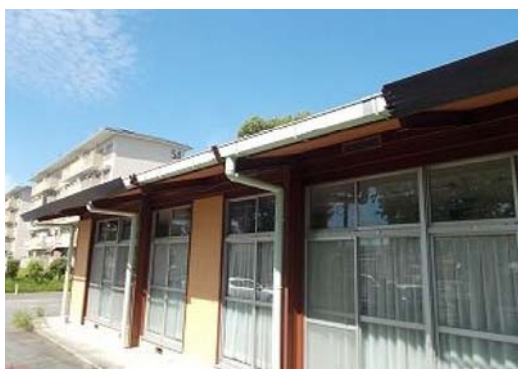
昭和老人憩いの家 (幕板の破損→2018 年度修繕済)
