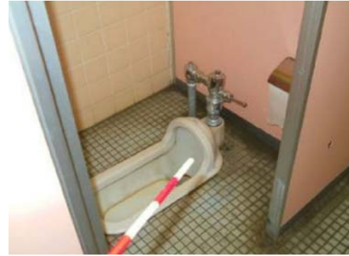
写真 水洗の異常
