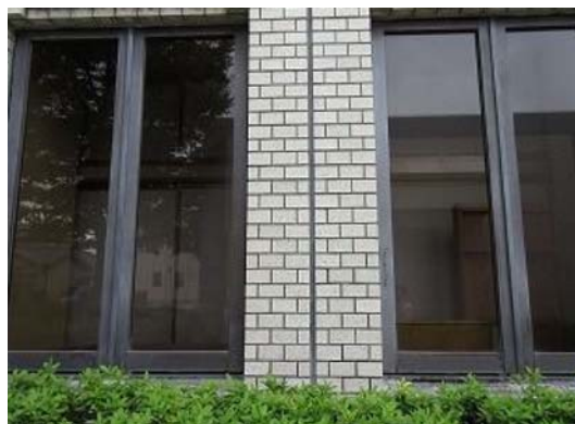
中央公民館-公民館 (目地材の全体的な劣化、切れ-漏水あり)
