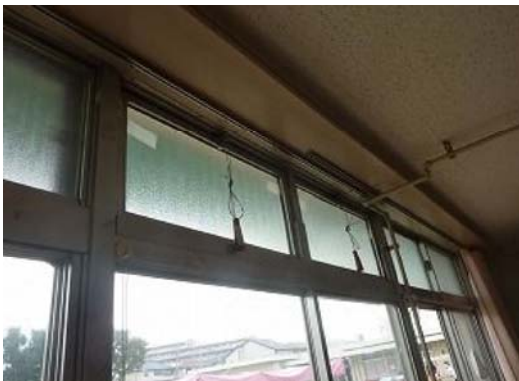
八橋保育園-園舎 (排煙窓テープ止め)
