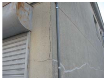
写真 外壁ひび割れ、剥離
