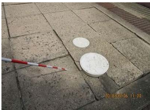
知立保育園-園舎 (配管点検口との段差、床下がり、つまづきの恐れ)
