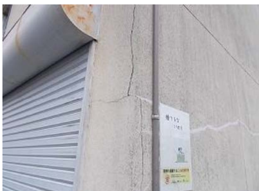
知立市役所-現業棟 (外壁ひび割れ)
