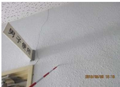
知立文化広場-ソーラー棟 (内壁ひび割れ)
