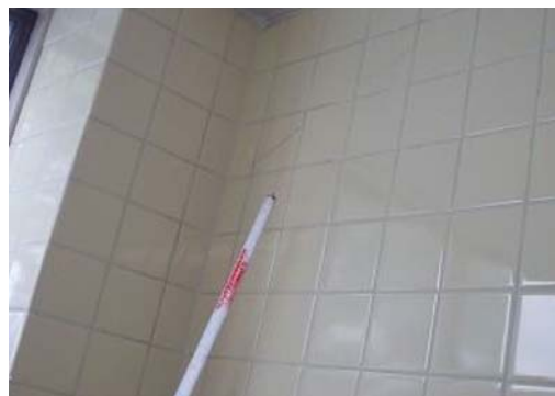
猿渡公民館 (壁タイル浮き、ひび割れ)
