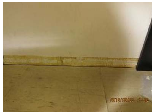
知立市役所-本庁舎 (巾木剥れ 全室共通)
