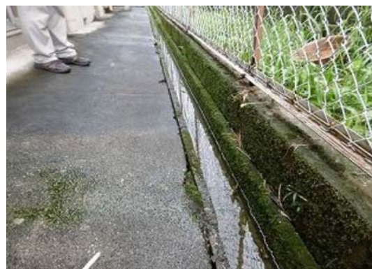
逢妻保育園-園舎 (側溝犬走り陥没割れ 全体的)
