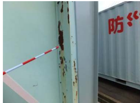
写真 鉄骨の錆
