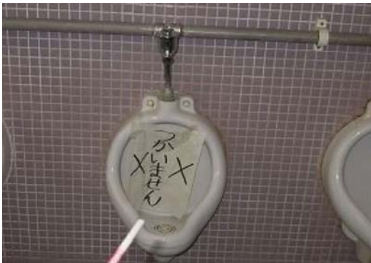
知立東小学校-校舎 (小便器故障)
