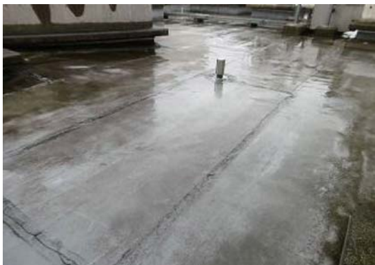
地域福祉センター (防水目地部の亀裂-現状で漏水なし)
