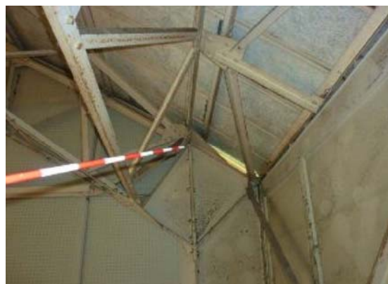
写真 屋根の腐食状況（端部）
