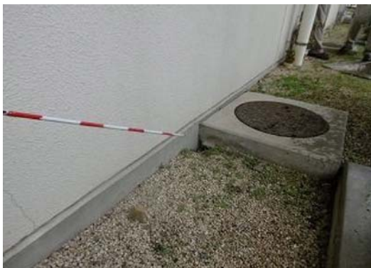
地域福祉センター (マンホール周り沈下、土砂流出≒10cm)
