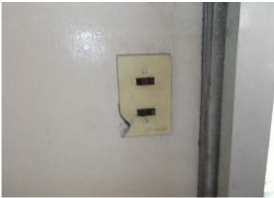
知立中学校-プール棟 (コンセントスイッチカバーの破損)
