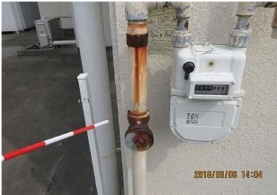
花山児童センター (ガス配管の錆)
