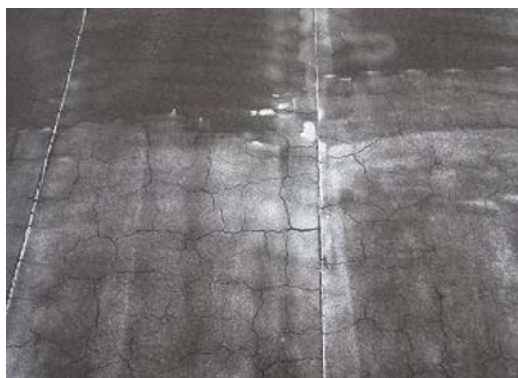
中央公民館-公民館 (防水層の亀裂、膨れ-天井漏水あり)
