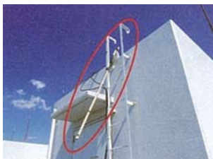
受信設備 (アンテナ等)
