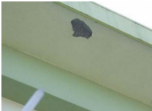
新林保育園-園舎 (軒天塗膜剥れ)
