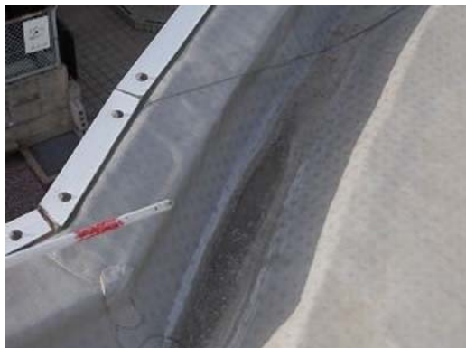
西丘文化センター (屋上水たまり-現状で漏水なし)
