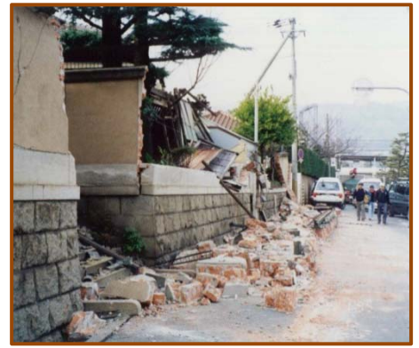
民家のレンガ造塀の倒壊 阪神・淡路大震災／平成7年（1995年） 写真提供：応用地質株式会社
